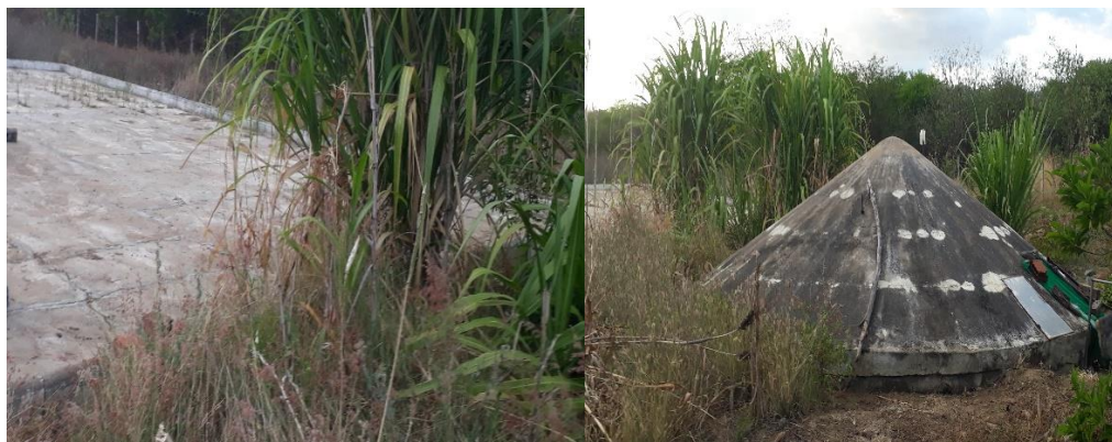
Figura 29: Cisterna calçadão Fonte: autoria própria (2020)
