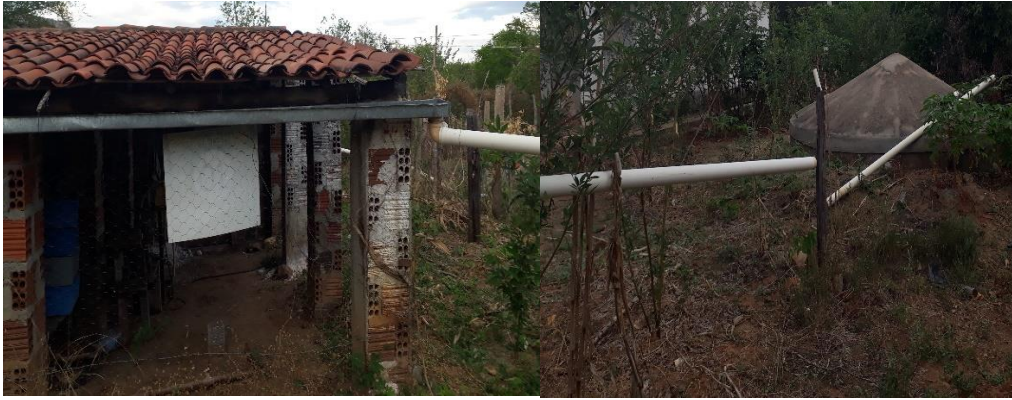
Figura 28: Cisterna telhadão Fonte: autoria própria (2020)
